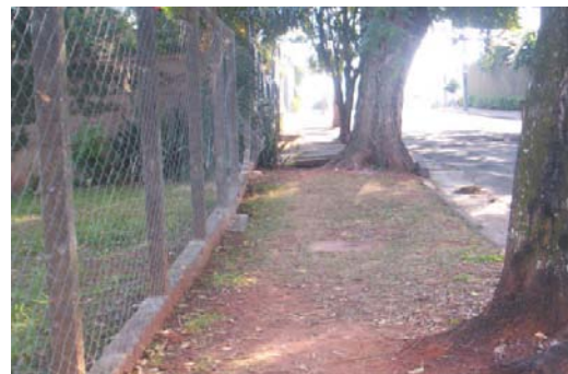
2. Falta de piso e vegetação com porte inadequado.
