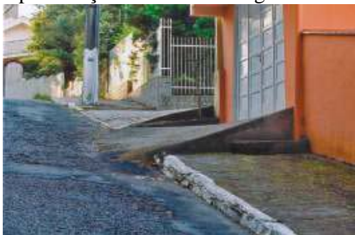
1. Degraus e inclinações transversais excessivas.
