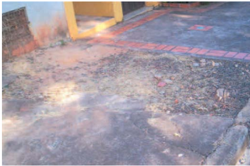
3. Descontinuidade no piso.
