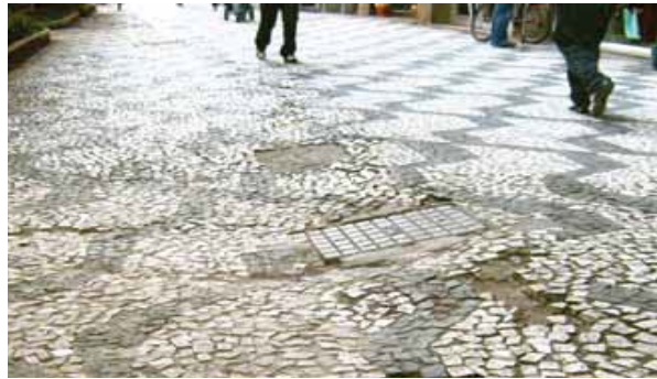
4. Material de piso inadequado e sem conservação.
